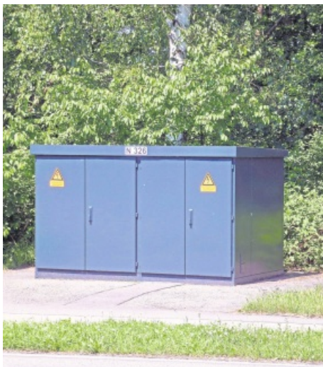
Nicht schön, aber nützlich: Stahlblech-Kompaktstation in Karlsruhe-Neureut
